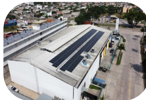
JUANAUTOS CAPACIDAD: 0.086 MWp
