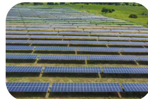
PARQUE SOLAR CANAL DEL DIQUE CAPACIDAD: 5.6 MWp
